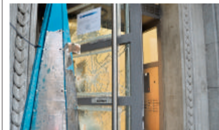
Nach der Demonstration ist die Glastür des SVP-Sekretariats demoliert.
